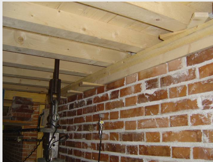
APPLICAZIONE DI CARICO CONCENTRATO DI ENTITA' CRESCENTE MEDIANTE MARTINETTO OLEODINAMICO VINCOLATO A TERRA ED ALLE DUE TRAVI CENTRALI DEL SOLAIO
