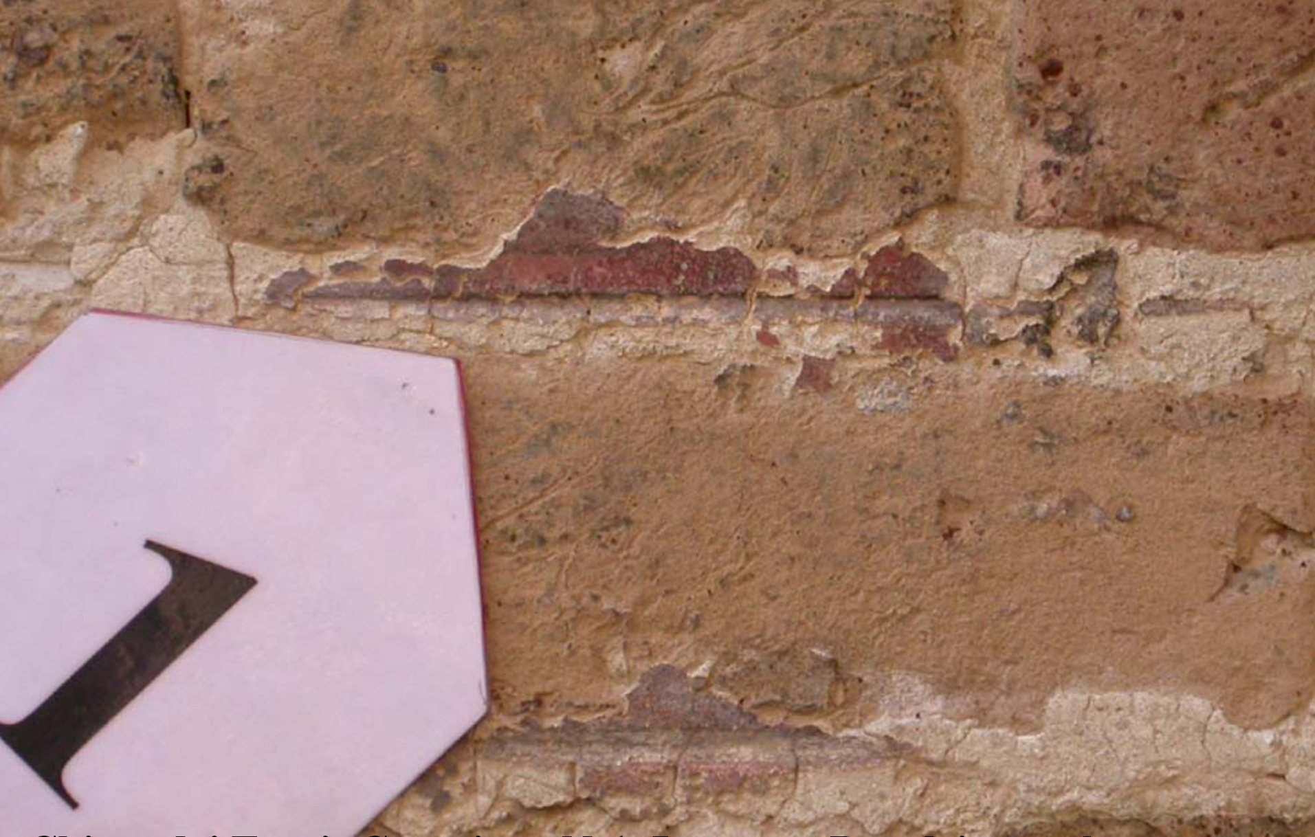
•Chiesa dei Frari: Campione N:1. Intonaco Regalzier prelevato su malta tra due mattoni della facciata principale a circa 180 cm da terra
