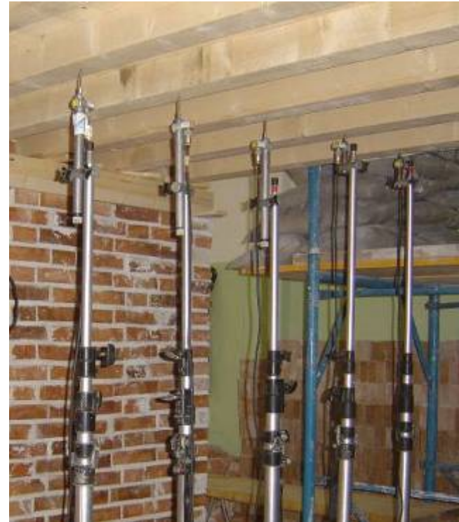
Abbassamenti travi del primo solaio
